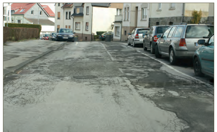
Erhöhte Oberflächenschäden in der Straße Am Ballo
