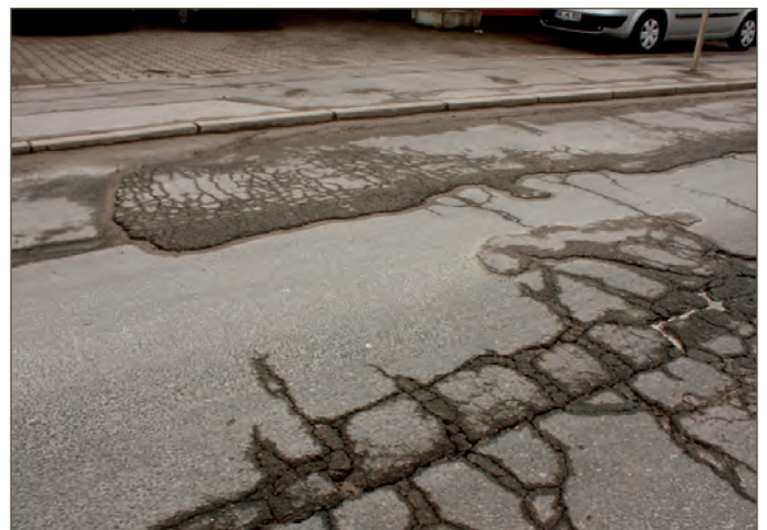
Oberflächenschäden in der Oesestraße
